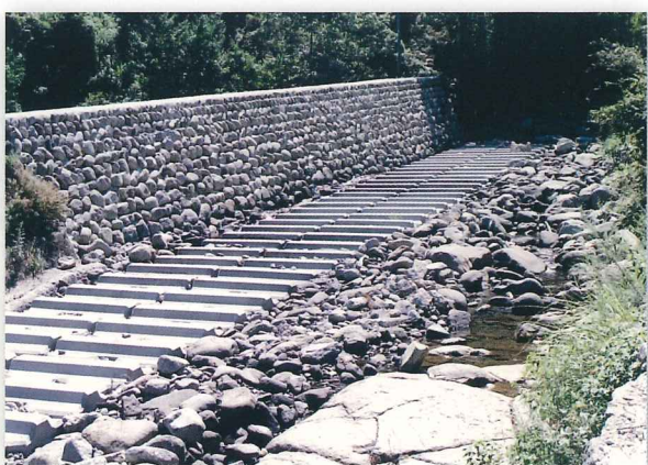
大分県 串川 日田土木事務所 6t
